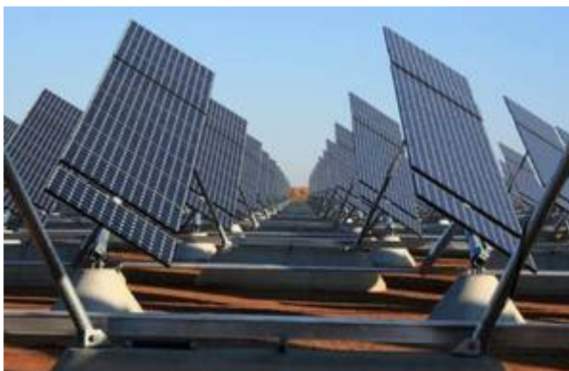
Figura 6.13 – Planta Solar Fotovoltaica de 1 MW da Universidade da Califórnia – UC Merced (2009).
